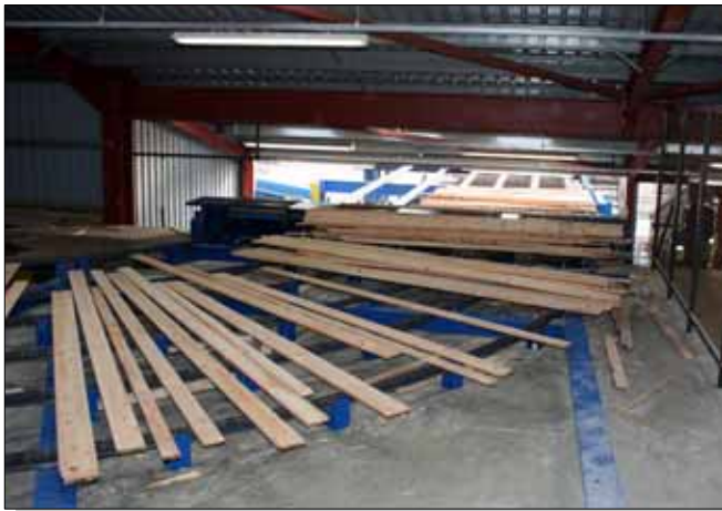
Holzzuführung zur Sortieranlage über einen 90° Bogenförderer
